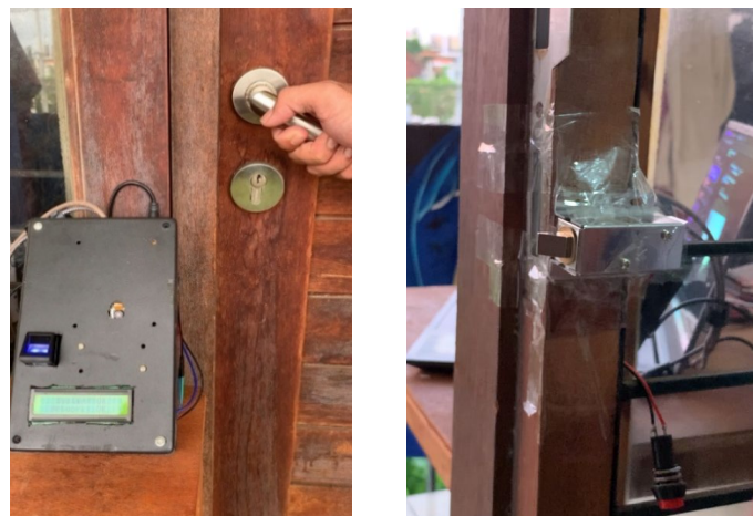
Gambar 3. Implementasi pada pintu
